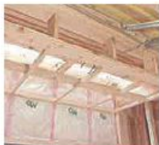
① 外壁を先行して断熱し石こうボードで押さえ、その後下がり壁と野縁を造作します。
