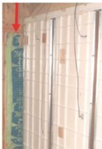
間違った施工
