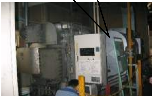
ガス吸収式冷温水機
