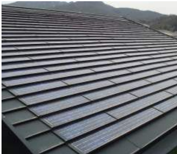
太陽光発電設備(三田営業所)
